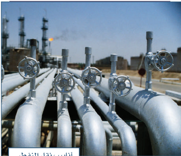
أنابيب نقل النفط
