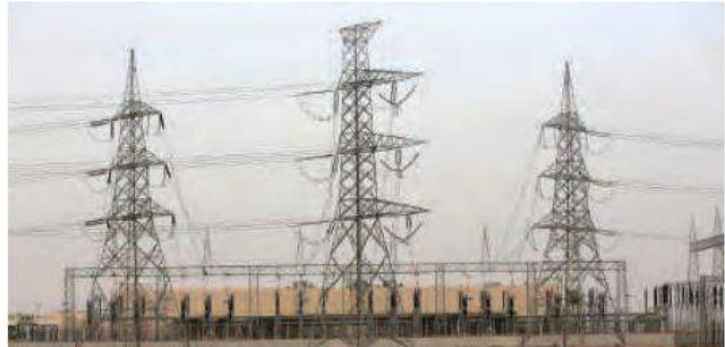
محطة سدير لتحويل الكهرباء
